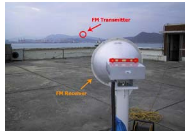
그림 23. 10km 수신지점의 FM수신기 설치사진 Fig. 23. Photograph of Wireless Transmission test in 10km Receive Site.
