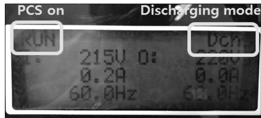
그림 6. ESS 동작시험(방전) Fig. 6. Operation Verification of ESS (ESS Discharging Status Monitoring)
